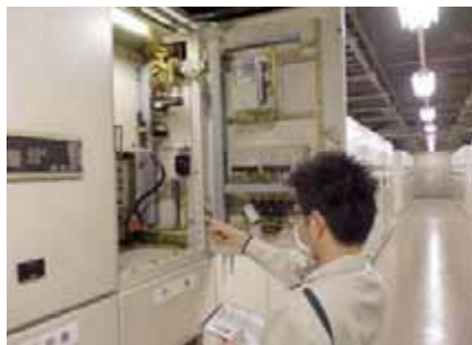
電気室 電気設備点検業務
