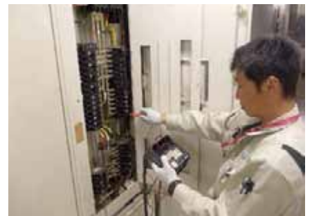
分電盤 絶縁測定業務
