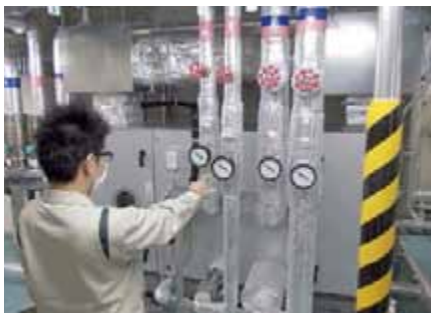
空調機設備 点検業務
