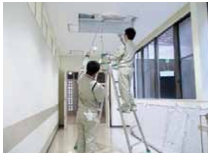
ファンコイル設備 点検業務
